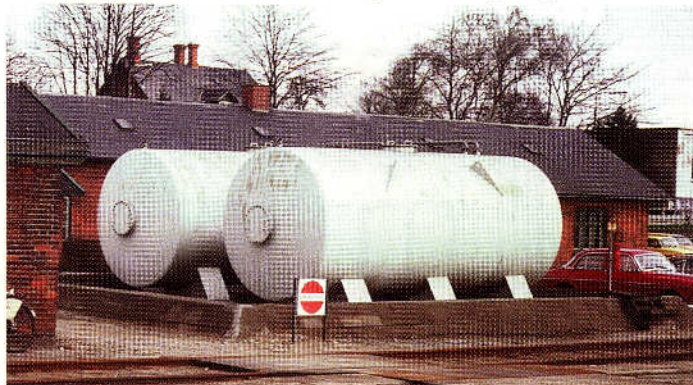
Tankanlæg med brændolie til forsyning af diesellokomotiver. Beholderne er omkranset af betonkanter for at undgå forurening. Slagelse 1978.
